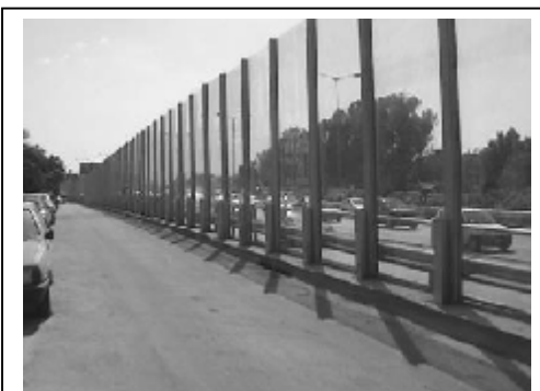
Κατασκευή ηχοπετάσματος σε νησίδα, από την στάθμη του πεζοδρομίου χωρίς σκυροδετημένο στηθαίο ασφαλείας. Η μπαριέρα που φαίνεται είναι η παλαιά που δεν αφαιρέθηκε και ευρίσκεται από την πίσω πλευρά
