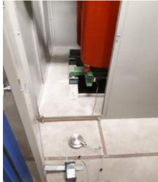
Σχήμα 4.1. Μέτρηση των κραδασμών μετά την τοποθέτηση των αντικραδασμικών πελμάτων στη βάση του μετασχηματιστή.
