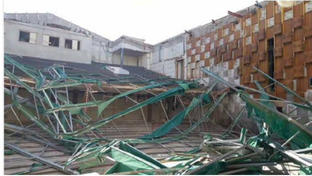
Σχήμα3.4: Η κατάσταση στο θέατρο μετά την κατάρρευση της οροφής και πριν από την έναρξη των εργασιών
